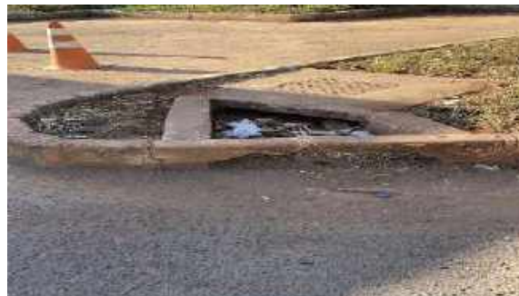
Esse é um dos nossos escoamento de águas pluviais , precisa de manutenção.
