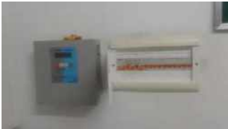
Essa é a nosso caixa de disjuntor do nosso Terminal.
