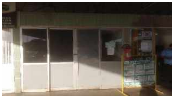
Mais uma esquadrias precisando de reforma.
