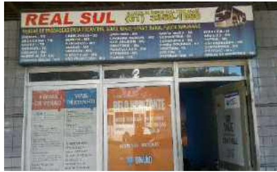
Portas de esquadrias precisando de reforma.
