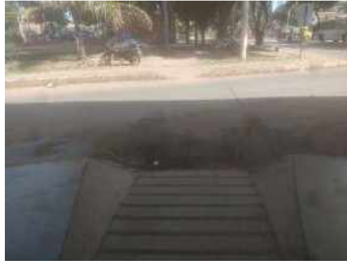
Essa era a nossa faixa de pedestre, precisa de uma manutenção.
