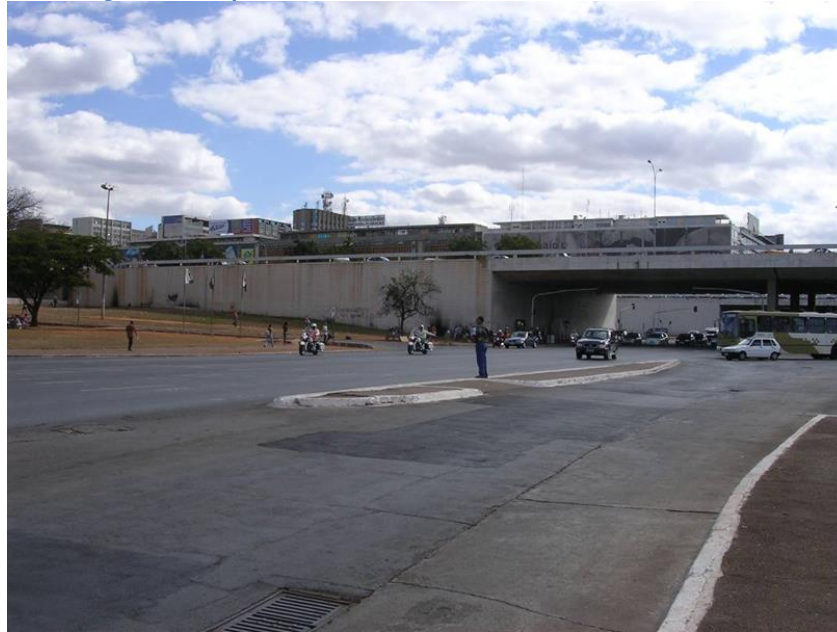
Figura 14. Reparos no Pavimento e Desníveis entre as Pistas
