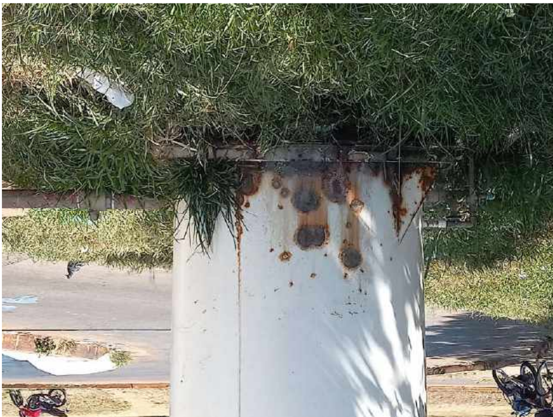
BASE DA CAIXA ENFERRUJADA 1
