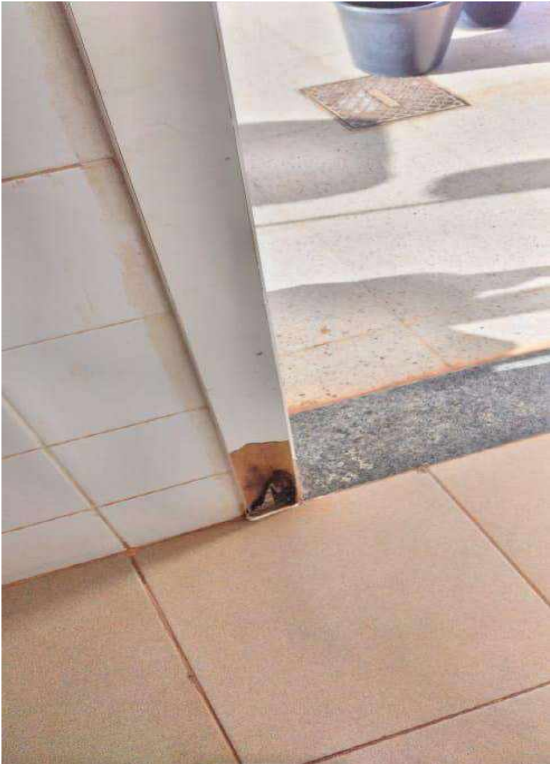
PORTAL DO BANHEIRO FEMININO QUEBRADO.
