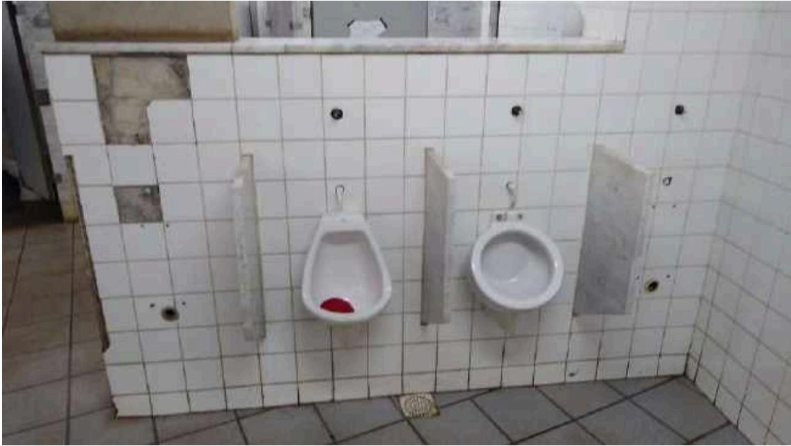
Mictórios faltando. Registros e válvulas faltando ou com defeito. Revestimento das paredes faltando.
