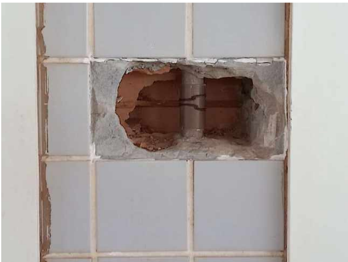
AUSÊNCIA DE PASTILHAS 1
