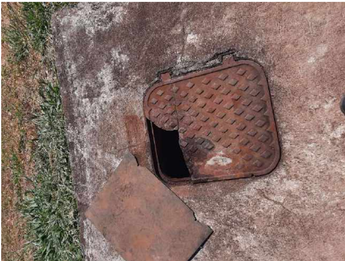
TAMPA DE ESGOTO DANIFICADA 1
