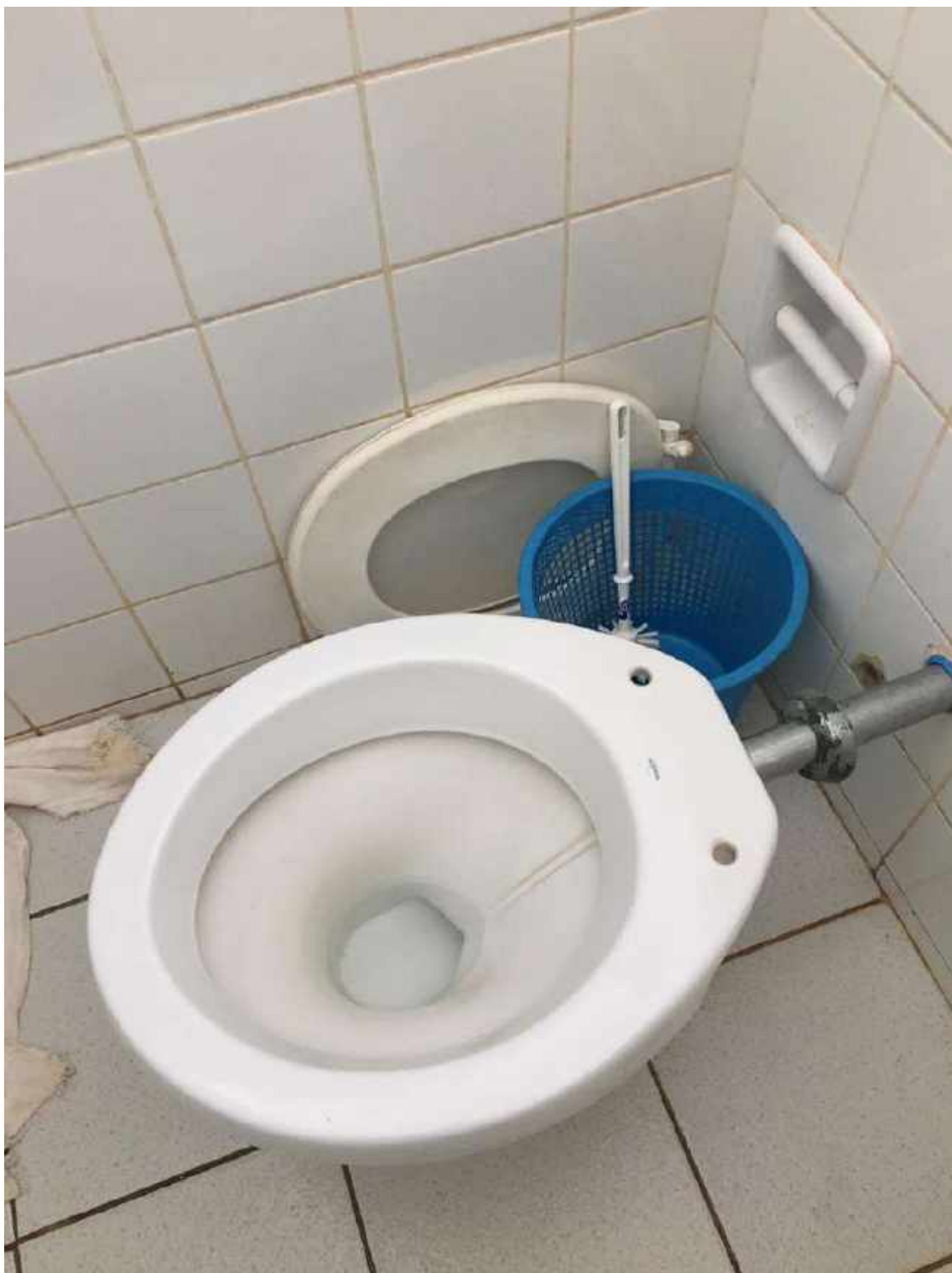
SANITÁRIOS SOLTOS E/OU SEM TAMPA
