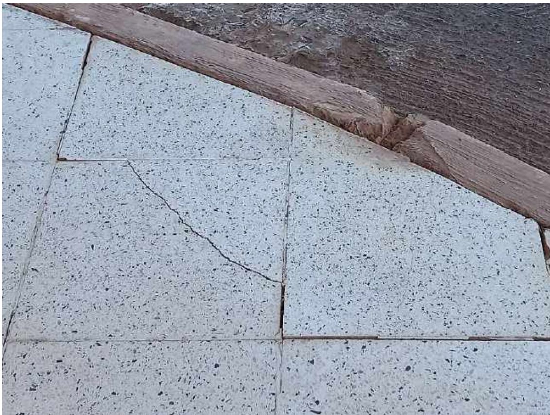
PISO DA PLATAFORMA DANIFICADO 1
