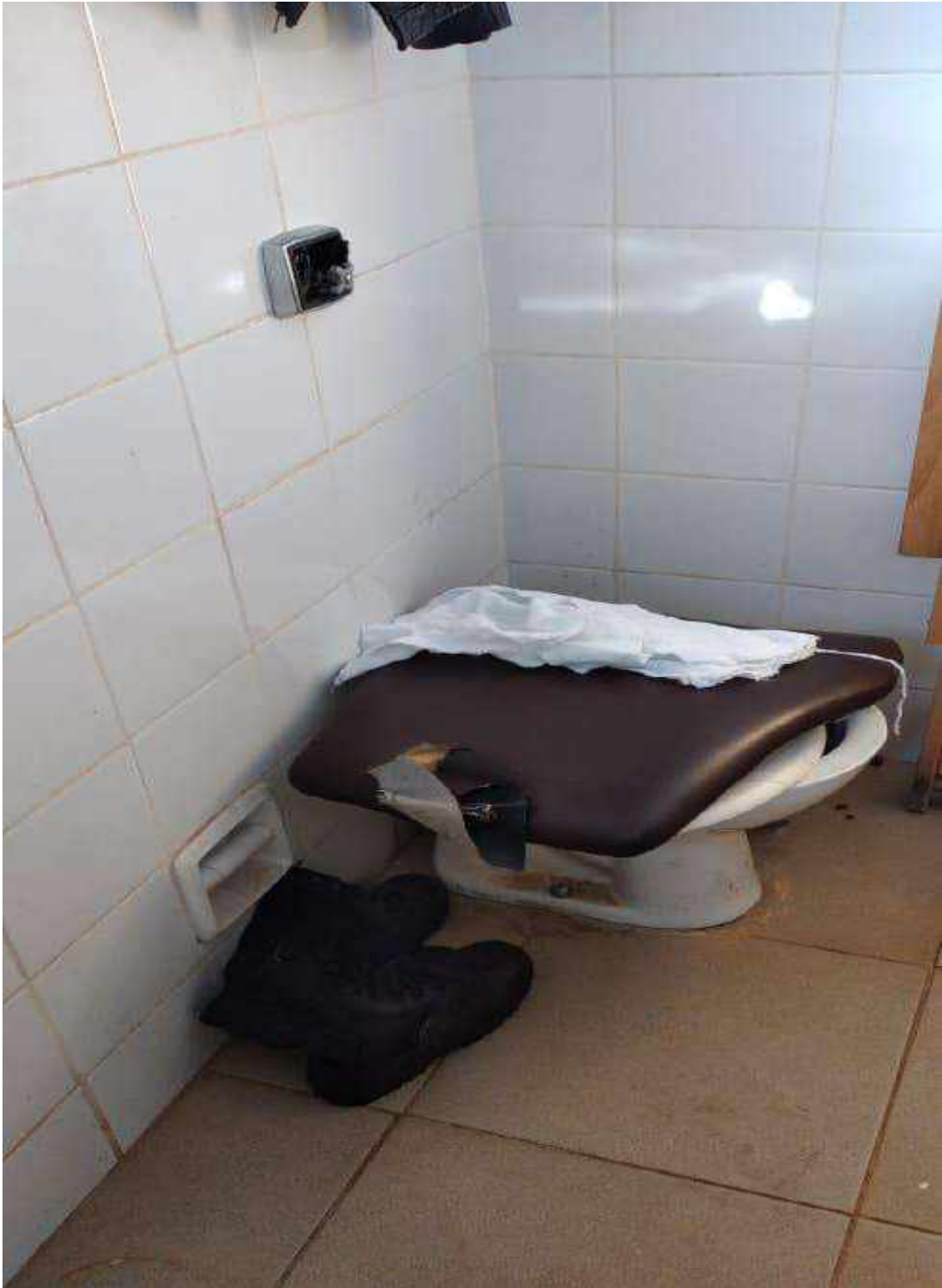
VASO QUEBRADO DO BANHEIRO PREPOSTO.
