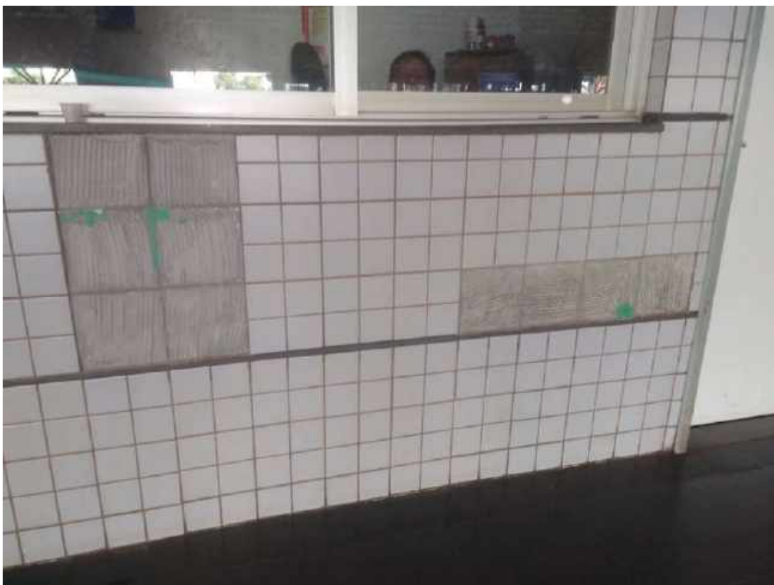
AUSÊNCIA DE PASTILHAS 1
