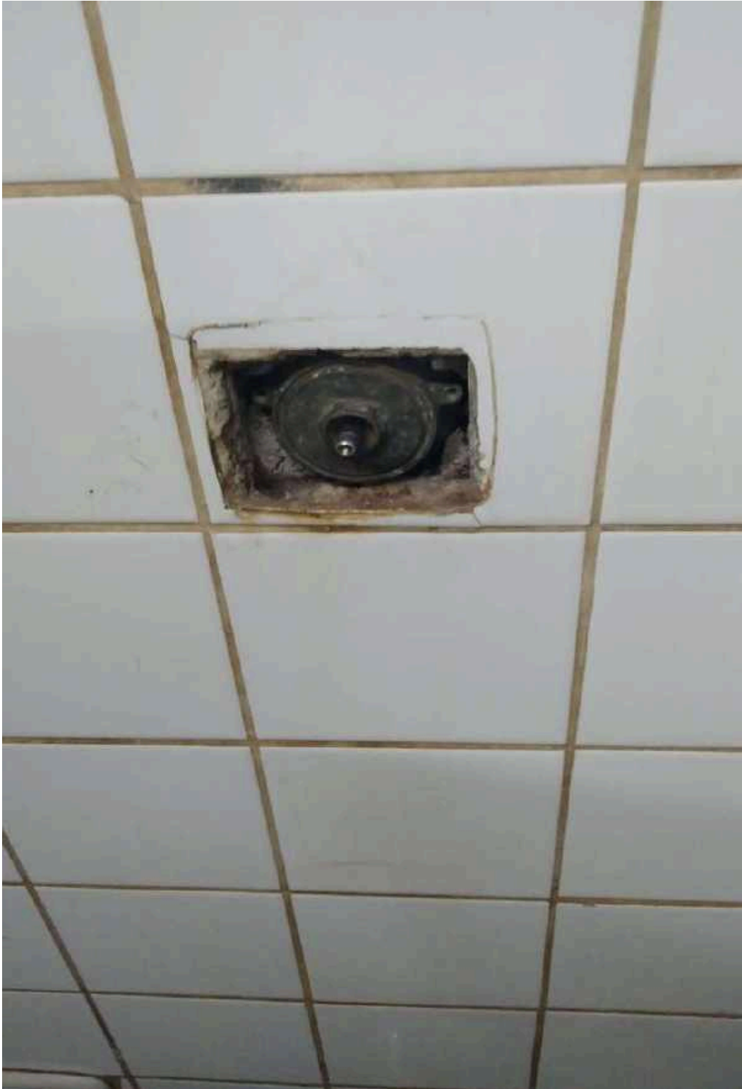
Válvula de descarga com defeito
