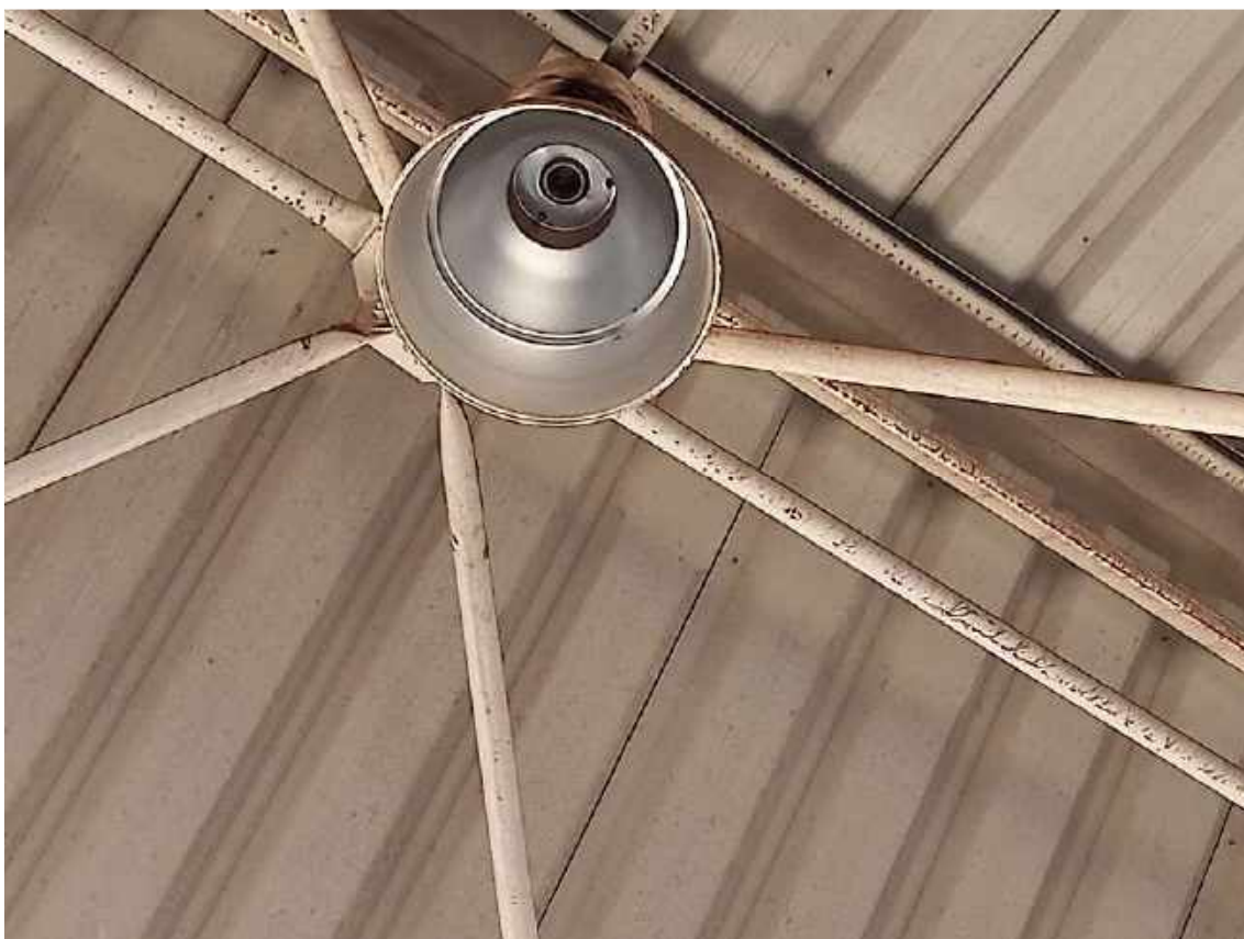
AUSÊNCIA DE LÂMPADAS 1
