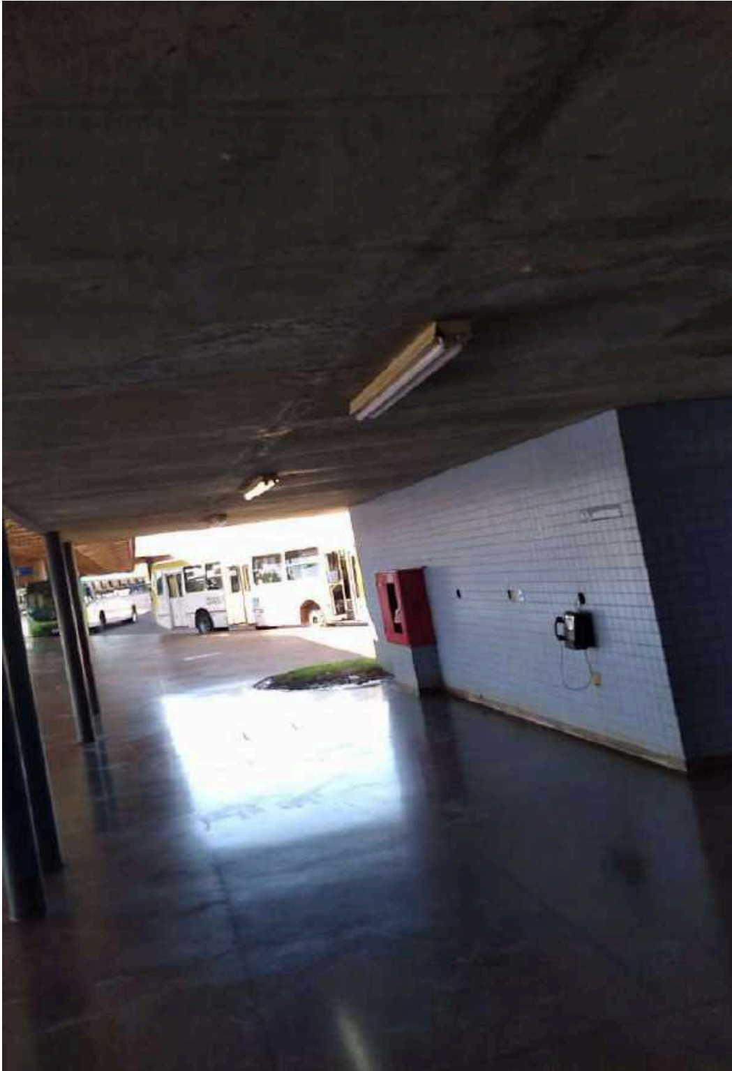
Lâmpadas de 40w fluorescentes e reatores queimados.
