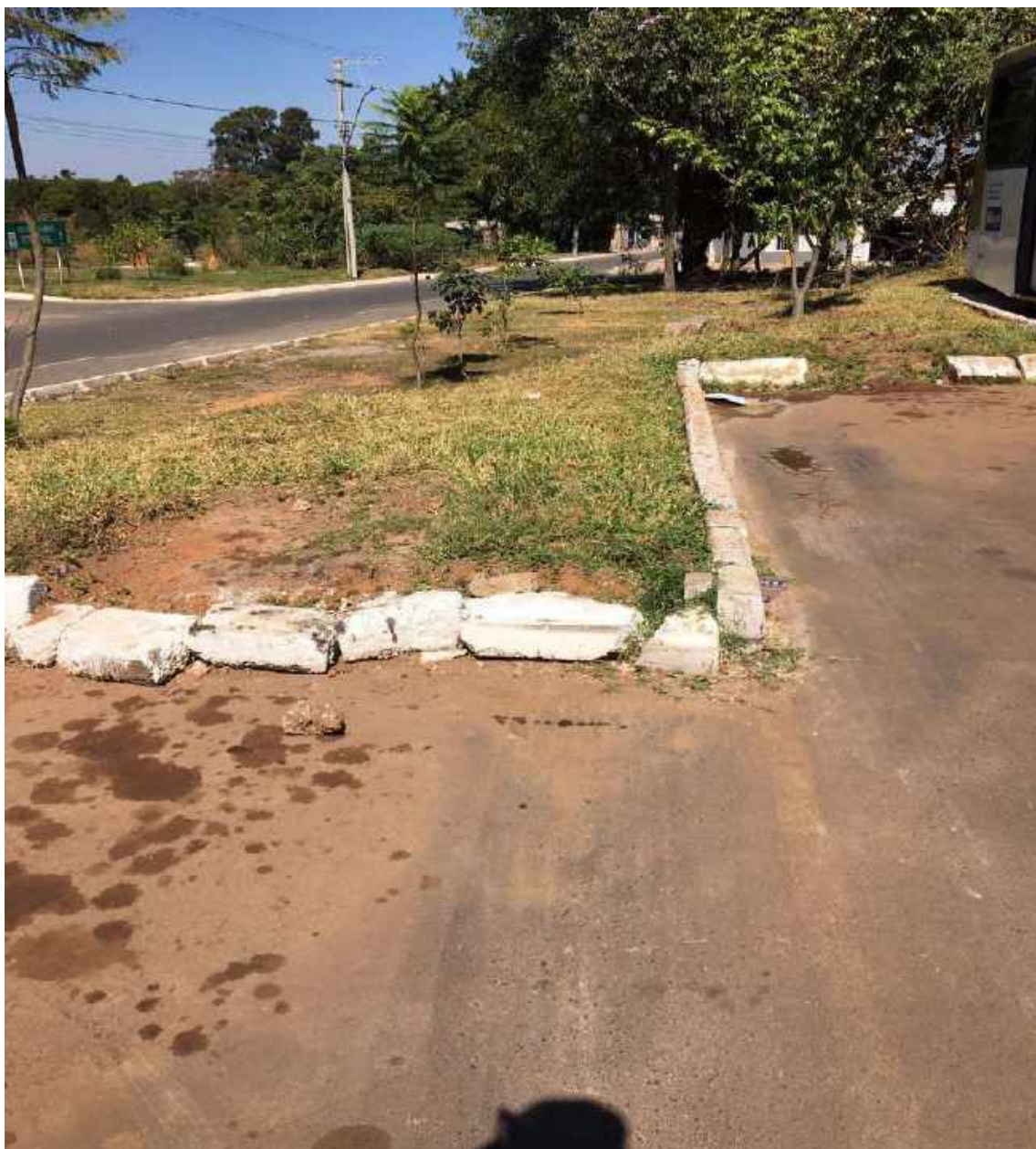
MEIO FIO QUEBRADOS
