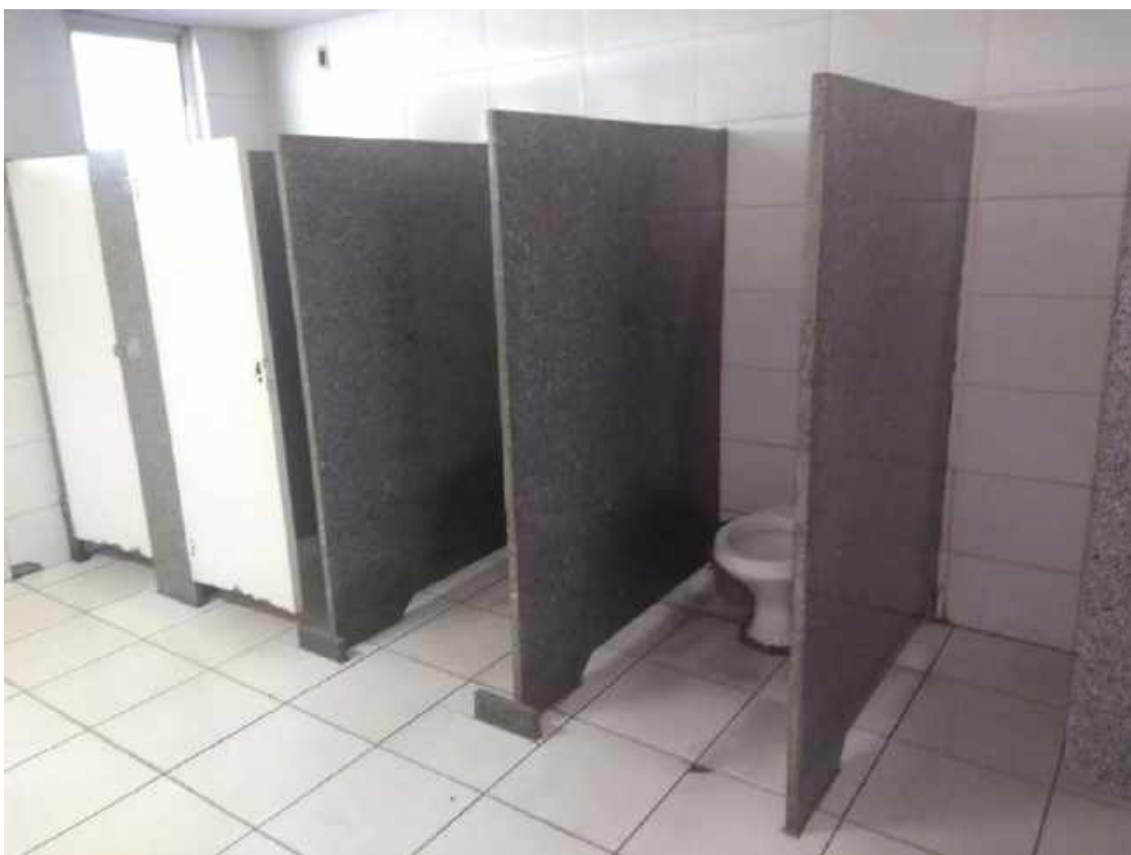
AUSÊNCIA DE 2 PORTAS NO BANHEIRO MASCULI 1
