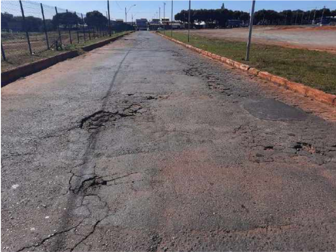
NECESSÁRIO RECUPERAR MALHA ASFÁLTICA 1
