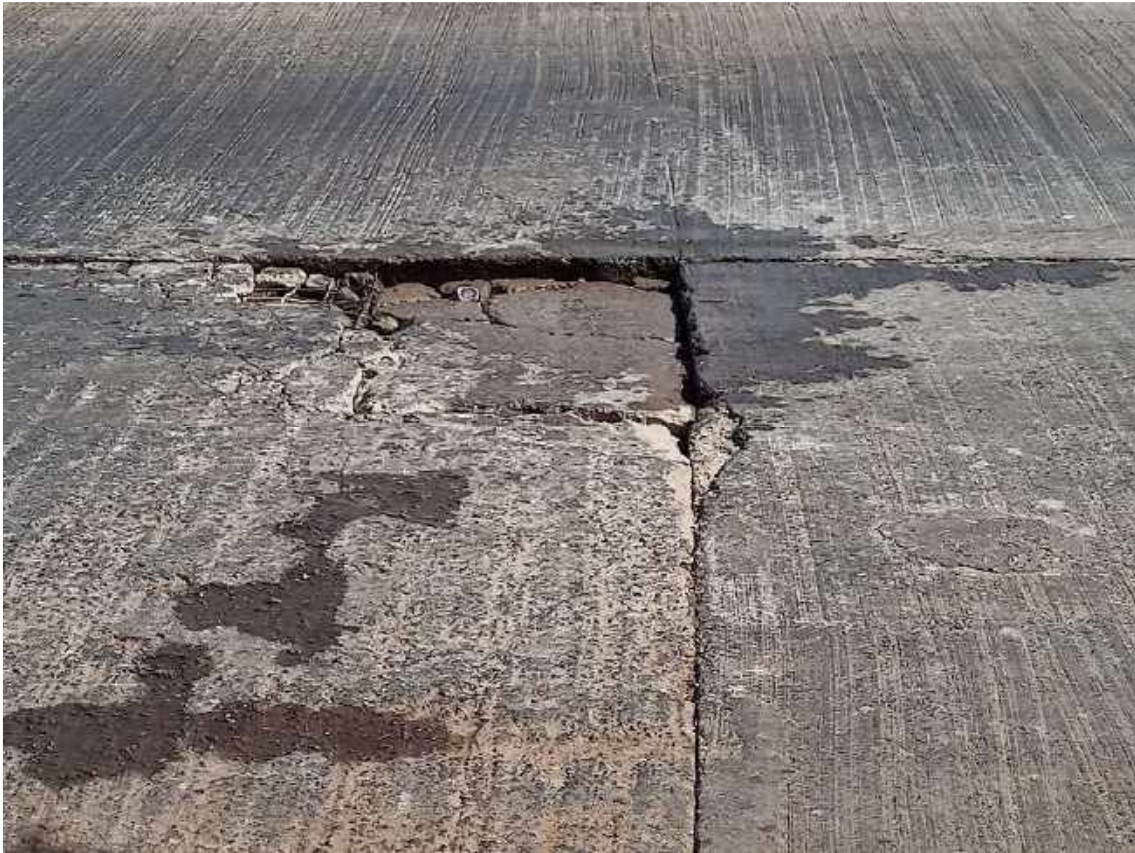
PAVIMENTAÇÃO COM BURACOS 1
