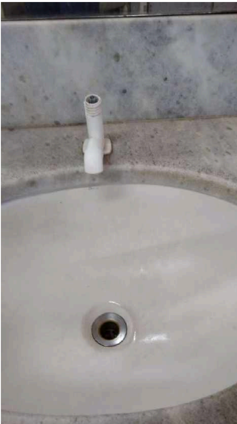
Torneira plástica de bancada para lavatório. Quebram o registro com frequência.
