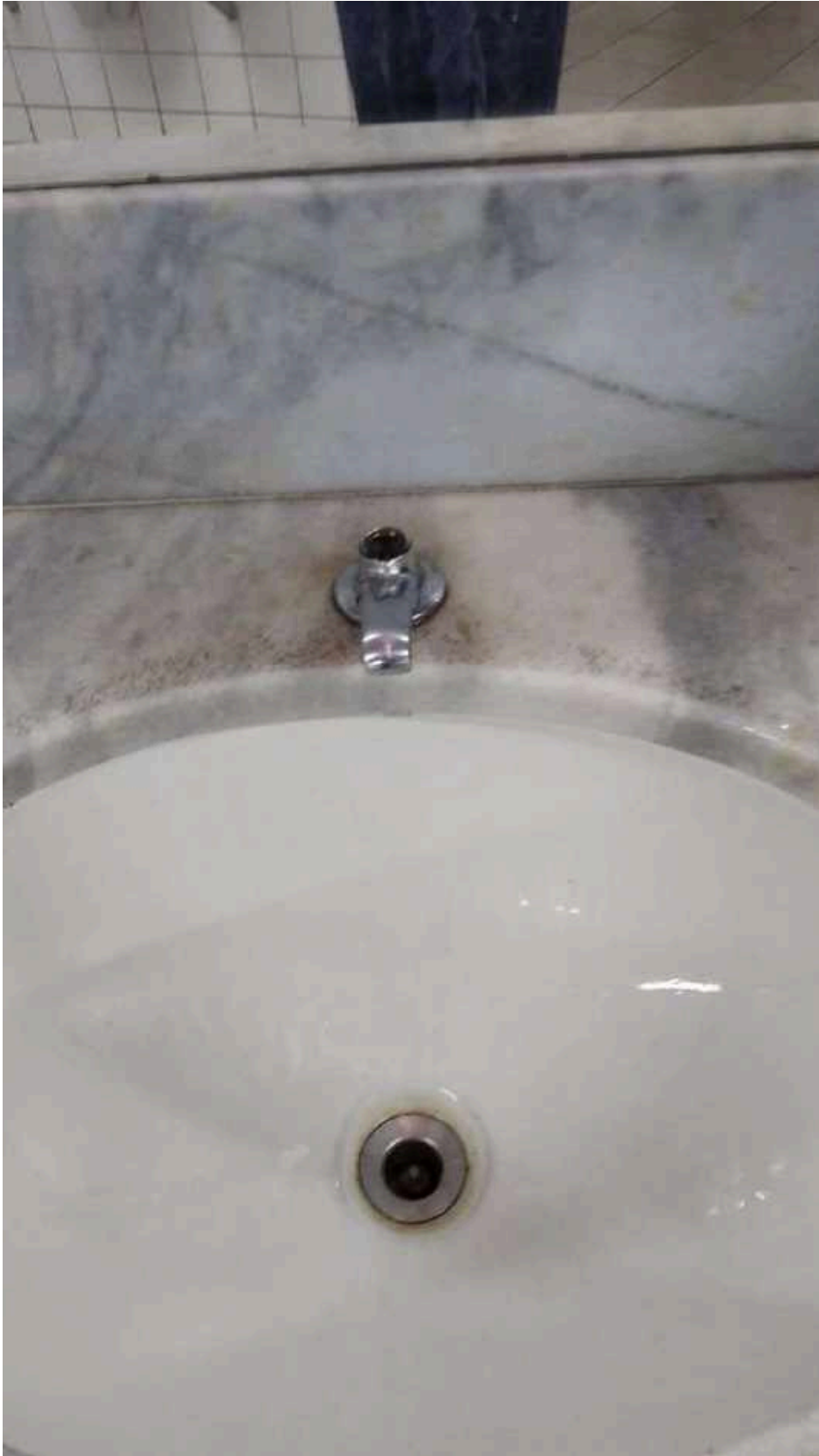
Torneira metálica de bancada para lavatório. Quebram o registro com frequência.
