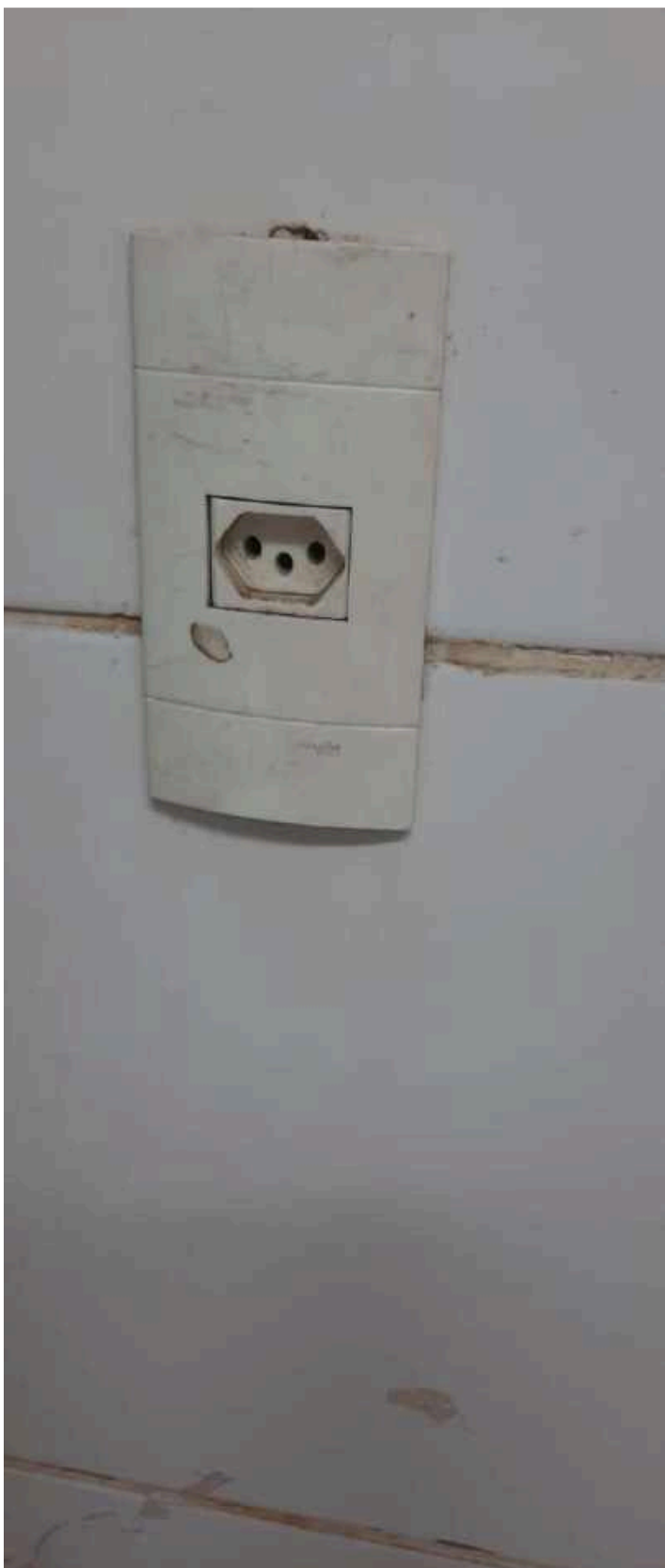
TOMADA COM DEFEITO 1
