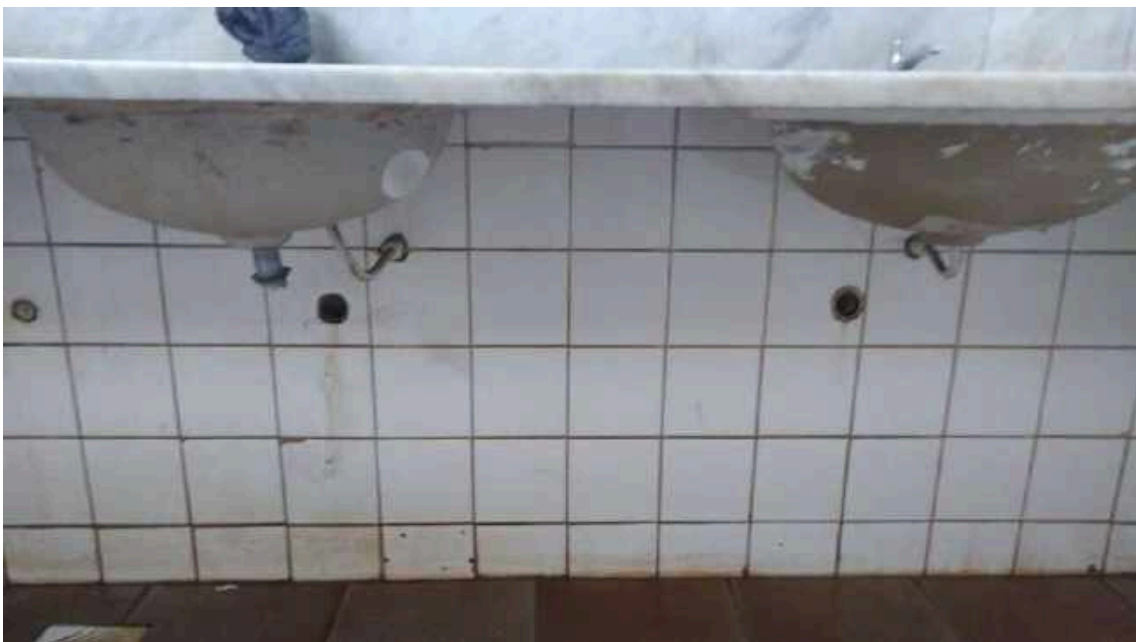
Válvulas e sifões de lavatório faltando.
