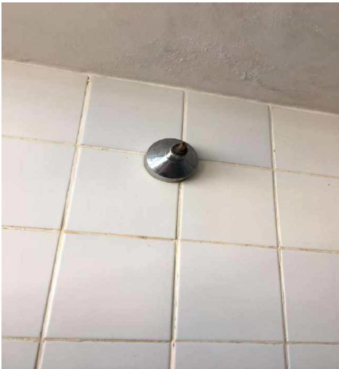
REGISTRO SEM TAMPA
