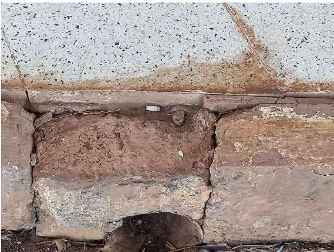
MEIO FIO DANIFICADO 1
