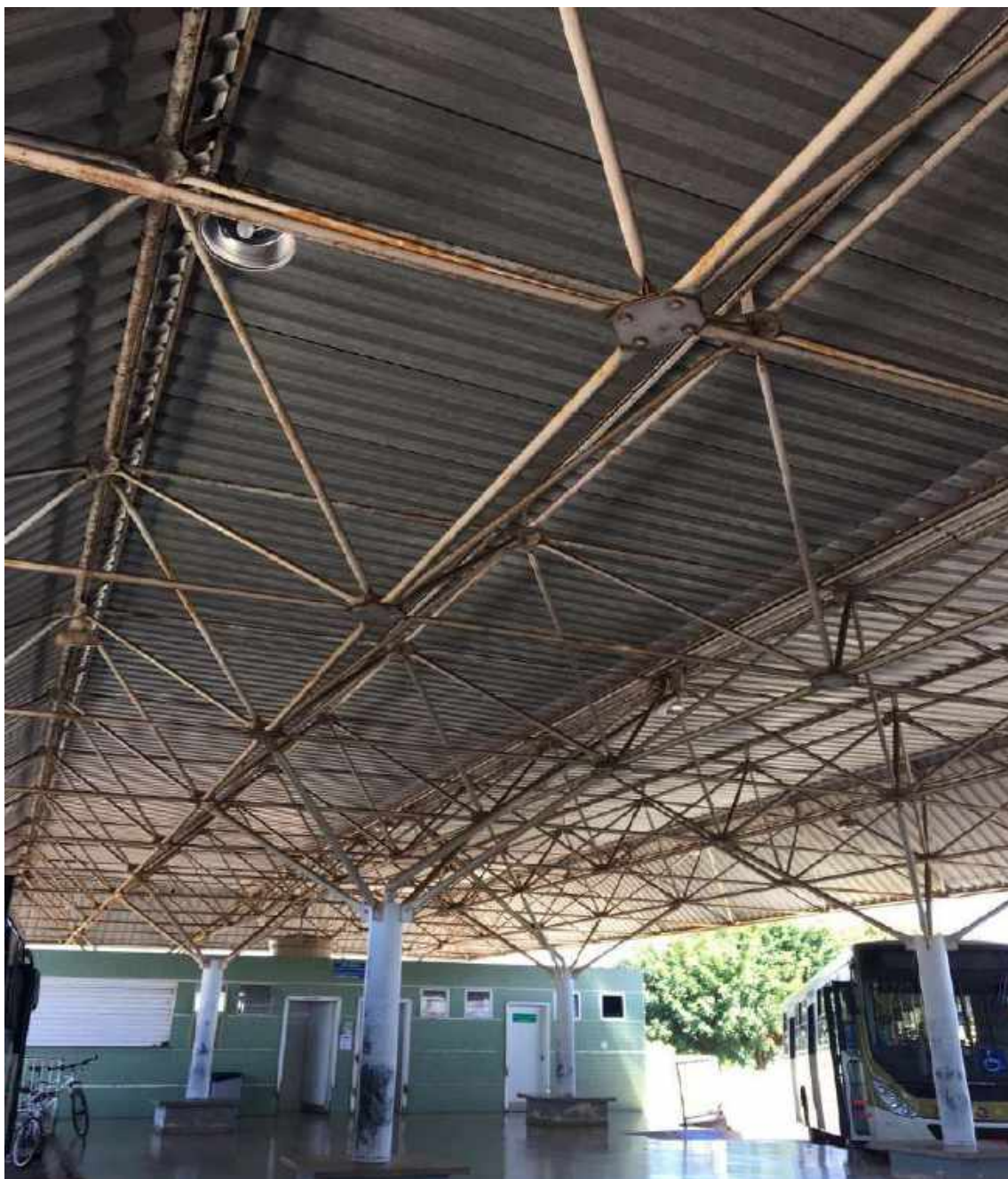
Pilares e Estrutura metálicas necessitando de pintura
