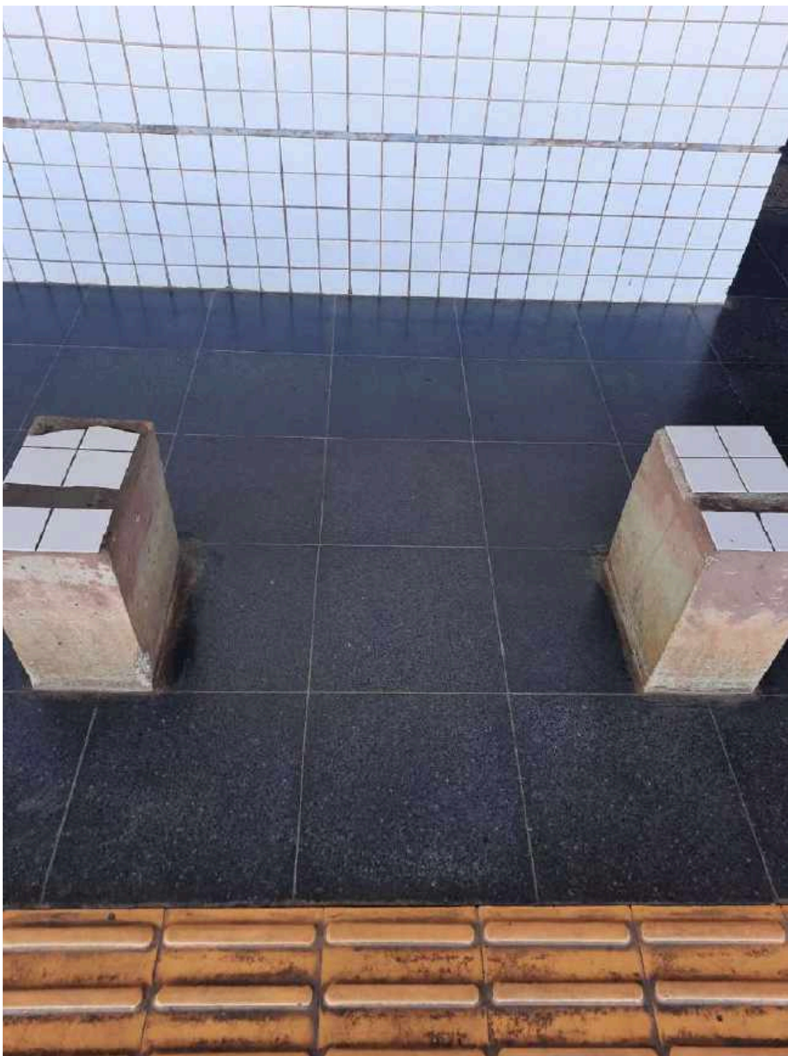
AUSÊNCIA DE BANCO 1
