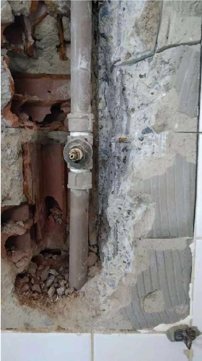
Registro de 32 mm com vazamento.
