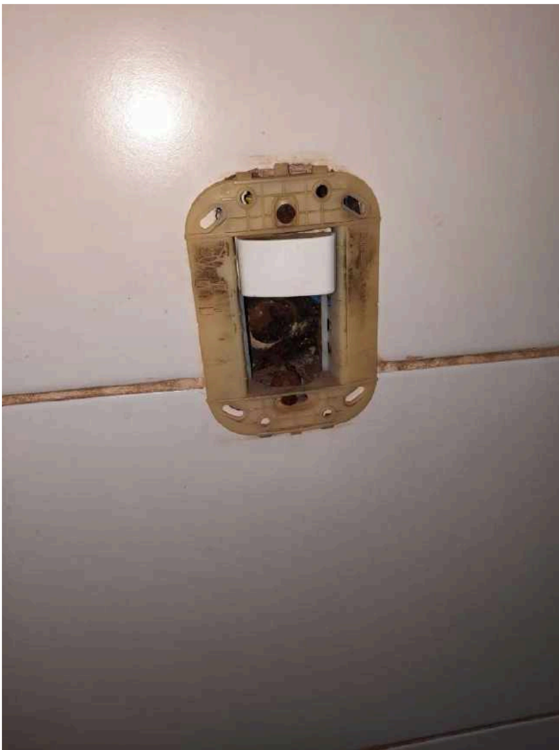
INTERRUPTOR CONJUGADO SUBSTITUIR 1
