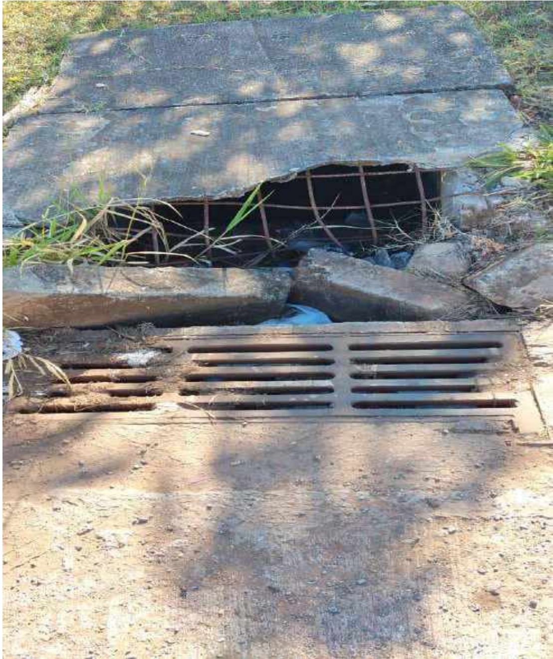
BOCA DE LOBO QUEBRADA
