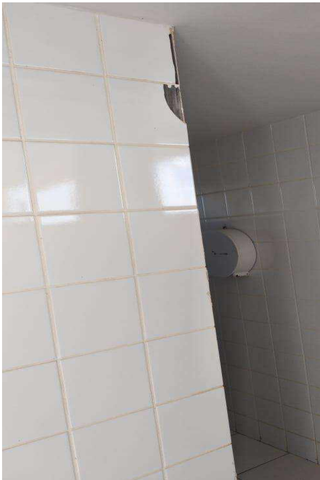
AZULEJO DA PAREDE QUEBRADO DOS BANHEIROS FEMININO E MASCULINO
