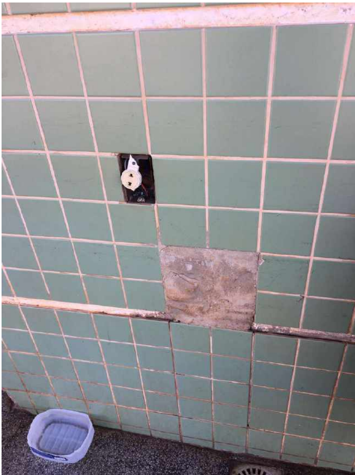
TOMADAS E CERÂMICAS QUEBRADAS
