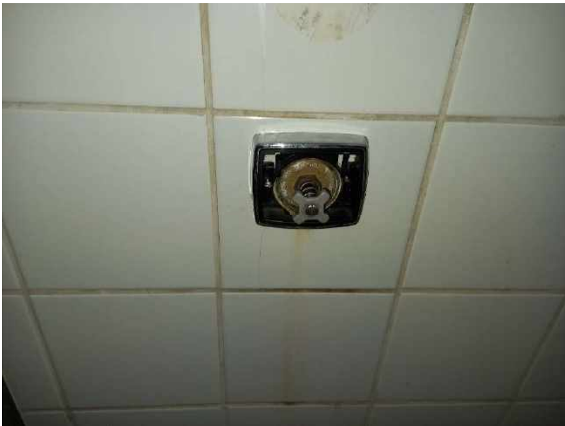
VÁLVULA DE DESCARGA DE BANHEIRO 1
