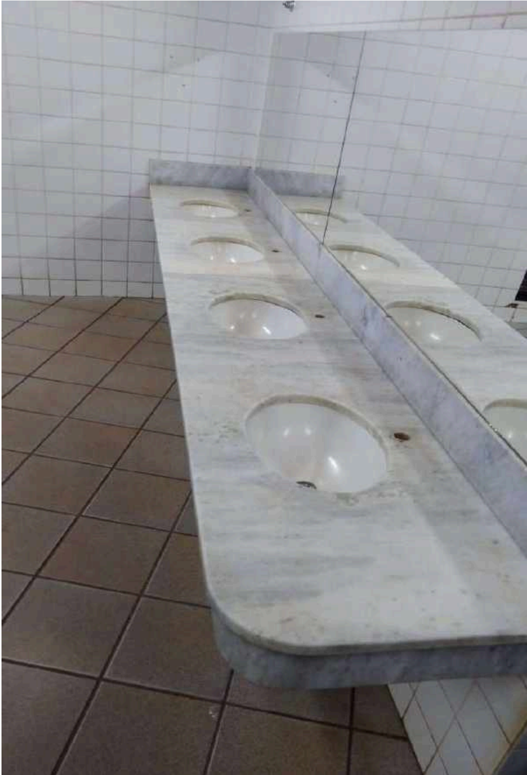
Lavatórios sem torneiras
