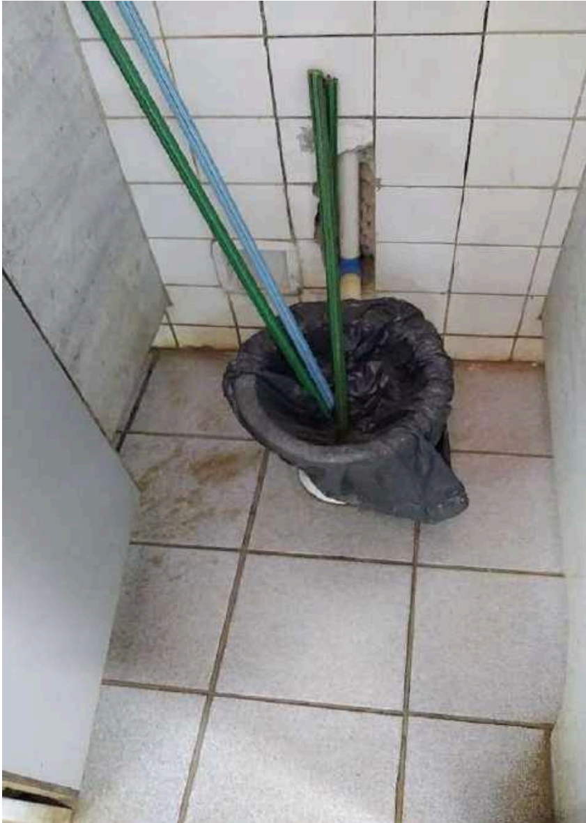
Vaso sanitário com vazamento
